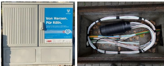
Glasfaserverteilung (Schrank oder Muffe)
